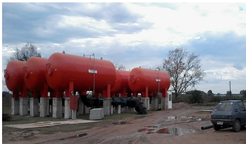
Figura 3: Cámaras de aire de la sexta línea de bombeo - Obras Sanitarias del Estado ( http://www.ose.com.uy/ ).
