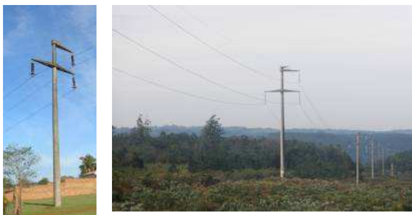
Figura 1: Línea de 132kV. Aristóbulo del Valle, Provincia de Misiones, Argentina.
