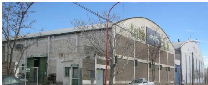
Figura 2: Galpón con cerramiento lateral de mampostería y techo parabólico de chapa ondulada, (Tatedetuti SA, Cipolletti).
